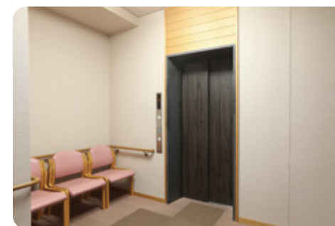
エレベーター
